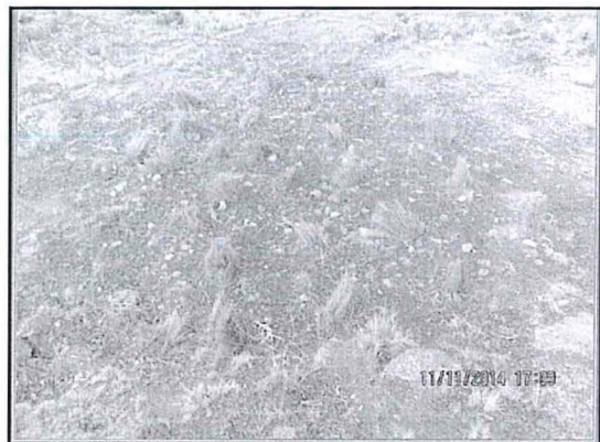
Fotografía N° 27: Poza de lodos de la plataforma P-15. Superficie de la poza de lodos, se encuentra cerrado. Los esquejes de ichu utilizados en la revegetación se encuentran secos (sin rebrote), lo cual difiere del entorno. Hallazgo N° 2.
