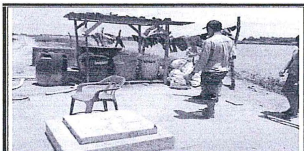
Foto N° 19: Vista panorámica del almacén temporal de residuos sólidos, también se observa el tanque del almacenamiento de agua potable.
