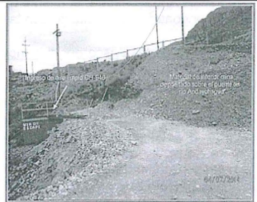
Fotografía N° 28: Hallazgo N° 2: Vista posterior del material acumulado sobre el puente del río Andaychagua, ubicado en las coordenadas (Datum WGS 84) N8702056, E389384.
