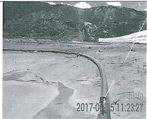
Foto N° 5 Actual riego por aspersión en el área de relave grueso cicloneado
