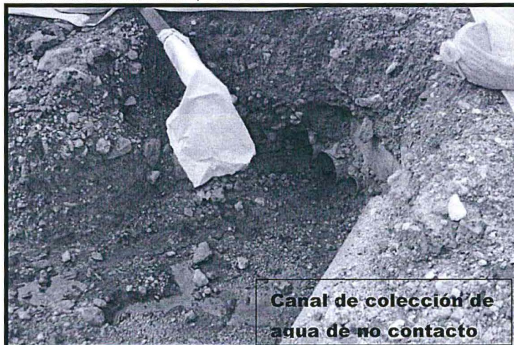
Fotografía N° 57.- Se observa tuberías a través de las cuales se descargan aguas provenientes de la escombrera nivel 420 - 490 hacia el canal de colección de agua de no contacto. Coordenadas WGS84 N 8568347, E521051.
