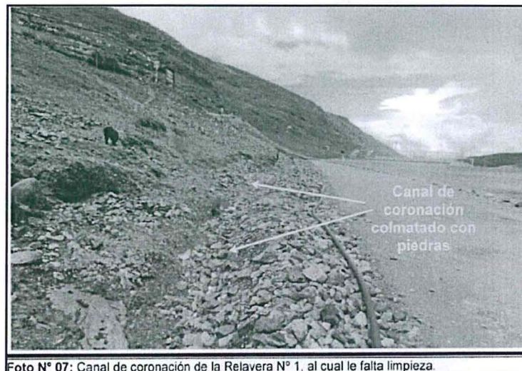
Foto N° 07: Canal de coronación de la Relavera N° 1, al cual le falta limpieza.
