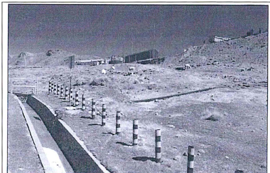
Foto N° 4: Descarga de agua del lavadero de botas N° 3 y canaletas al canal canal de coronación.
