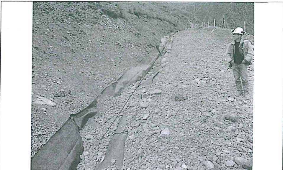
Fotografía N° 91.- HALLAZGO 01: En la vía de acceso aguas abajo de la estación Booster quebrada Tucush, las estructuras hidráulicas (cunetas de escorrentía) presentan acumulación de material y sedimentos.
