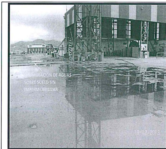
Fotografía N° 93: Hallazgo 5, se observa el agua producto de la limpieza de la loza de concreto discurriendo hacia zonas sin impermeabilizar, en el taller de mantenimiento de camiones.
