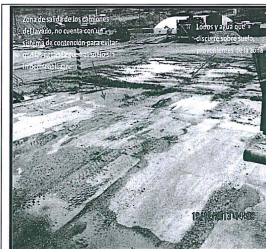
Fotografía N° 102: Hallazgo 6. Se observa acumulación de agua y lodo en las zonas adyacentes sin impermeabilizar del lavadero de vehículos. De igual forma se observa que la zona de lavado no cuenta con sistemas o estructuras de contención para el agua.
