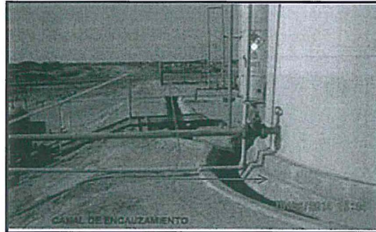
Fotografía N° 18 Tanque ubicado a una distancia aproximada de 1.50 metros de distancia de la pendiente de la plataforma que sostiene dicho tanque.
