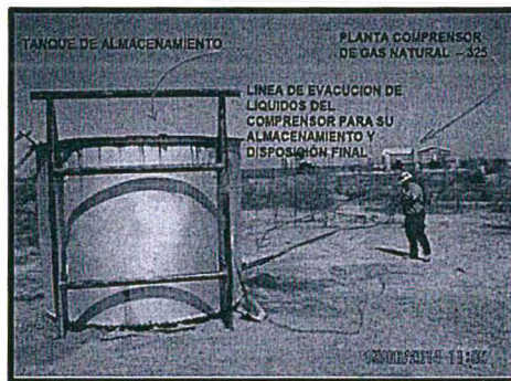
Fotografía N° 37 Descripción: Vista de Tanque 3228 que recibe los líquidos provenientes de la estación de compresor de gas.
