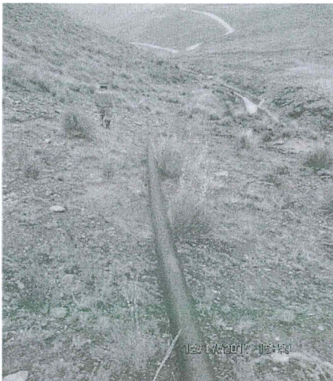
Fotografía N° 10: Tramo de inicio de la tubería HDPE 4" Ø que sale de la caja de recepción de la descarga de la poza de subdrenaje hacia la planta de tratamiento de agua de mina.
