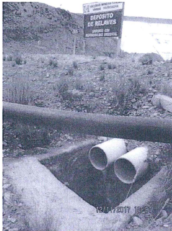
Fotografía N° 3: No existe rebose en las tuberías de descarga de la poza de subdrenaje.
