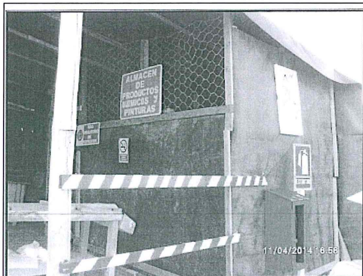
Fotografía 76: Hallazgo 6 – Vista del Almacén de Productos Químicos implementado indebidamente dentro del Taller de Reutilización
