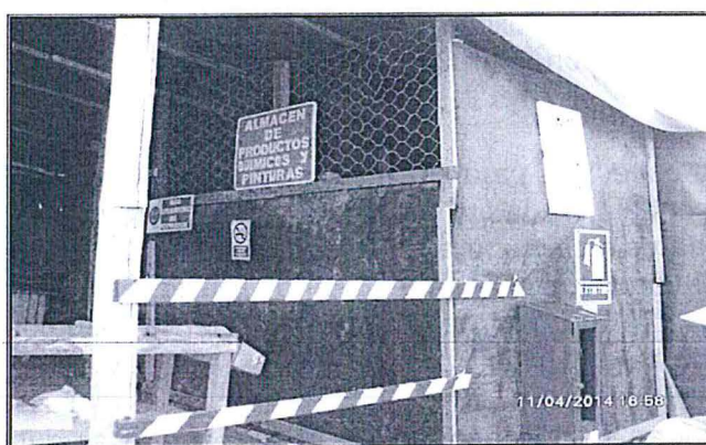
Fotografía 76: Hallazgo 6 – Vista del Almacén de Productos Químicos implementado indebidamente dentro del Taller de Reutilización
