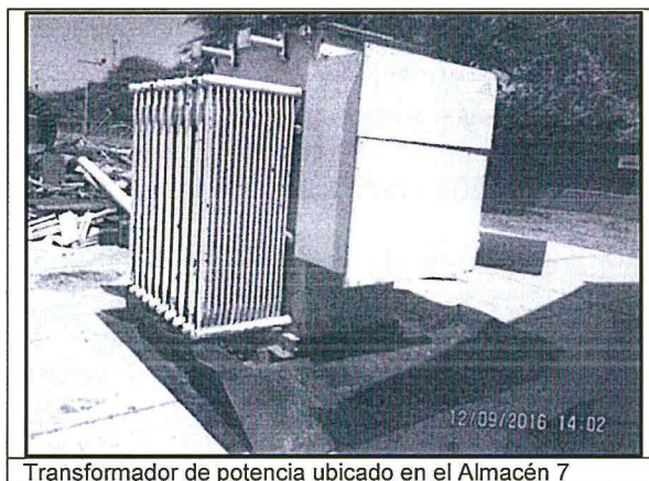
Transformador de potencia ubicado en el Almacén 7
