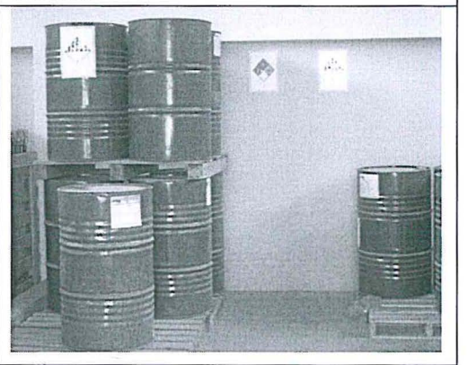
Fotografía 7: Señalización de Rombo de Seguridad para almacenamiento de cilindros con aceites dieléctricos
