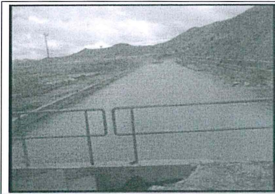
Foto N° 2: Se aprecia la reparación del muro del lecho de secado y colocación de una baranda metálica.
