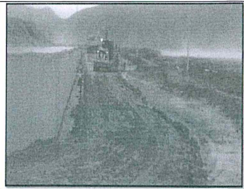
Foto N° 3: Equipos realizando la limpieza de las zonas aledañas al lecho de secado.
