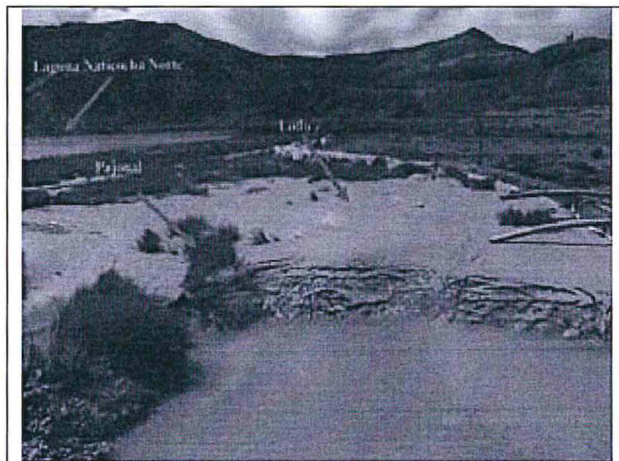
Fotografía N° 75: Hallazgo 6, Supervisión 2013: Otra vista de la parte superior de la laguna Naticocha Norte donde se observa los pajonales con lodos. Además, se observa un dique de contención impermeabilizado con geomembrana.
