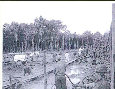
Foto N° 11: Se observa personal de la empresa realizando limpieza y recuperación de material derramado utilizando baldes plásticos con modalidad pasamanos y por bombas de succión. Todo material recuperado y de limpieza, están siendo dirigidas a la Poza 1503.
