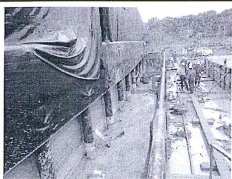
Foto N° 06: Se observa otra área estanque forrada con geomembrana aledaña a la Poza 1502, que sirvió para contener derrame de detritos de perforación. En el área de contingencia se observa contenido el material grueso sin recuperar y en la parte lateral de la Poza 1502, se observa charco con presencia de sólidos suspendidos de recortes y lodos de perforación.
