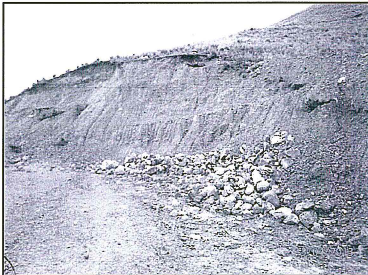
Vista 2. Caída de piedras y tierra en la vía de acceso en las coordenadas E 0410392 / N 8673875
