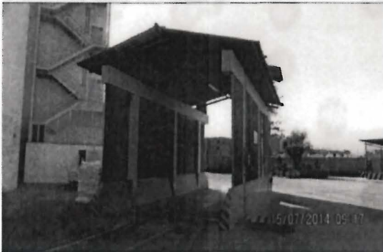
Fotografía HALL N° 1: Se observa el recinto de recepción de maíz, el cual está parcialmente cerrado y se evidencia las huellas (material particulado sedimentado) generadas por las llantas de los camiones durante su retirada.
