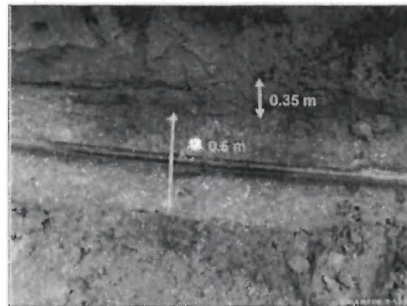
Fotografía N° 1: Vista del punto de rotura del ducto de fibra de vidrio de 2 pulgadas en el KP 2+500 de la Trocha Carrozable Puerto Oriente – Pacaya en el Lote 31E, donde longitud de zanja excavada es de aproximadamente 19.2 m para liberar el ducto, con un ancho de 0.5 m y profundidad de 0.35m (E: 0506061 / N: 9183710 / E: 0506014, N: 9183713)
