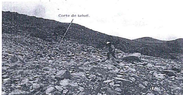
Fotografía N° 4. Vista del Área de la Plataforma sin identificación. La plataforma ejecutada, ubicado en las coordenadas UTM WGS 84 E. 376011 N. 8392989, se encontraba con corte en el talud, material producto del corte se encontraba dispuesto en la parte inferior de la plataforma.
