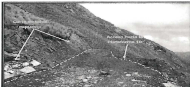
Fotografía N° 25: INCUMPLIMIENTO 2: Vista del acceso hacia la Plataforma 10. Presentaba un corte de talud expuesto. Coordenadas referenciales UTM WGS 84 - Zona 18: N 8 465 519; E 689 368.
