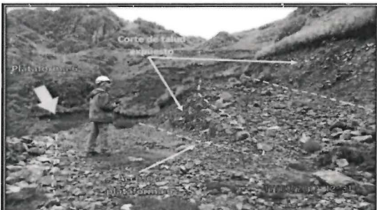
Fotografía N° 23: INCUMPLIMIENTO 2: Vista del acceso hacia la Plataforma 6. Presentaba un corte de talud expuesto. Coordenadas referenciales UTM WGS 84 - Zona 18: N 8 466 419; E 689 208.
