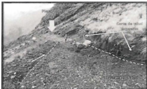
Fotografía N° 22: INCUMPLIMIENTO 2: Vista del acceso hacia la Plataforma 4. Presentaba un corte de talud expuesto. Coordenadas referenciales UTM WGS 84 - Zona 18: N 8 466 787; E 689 320.
