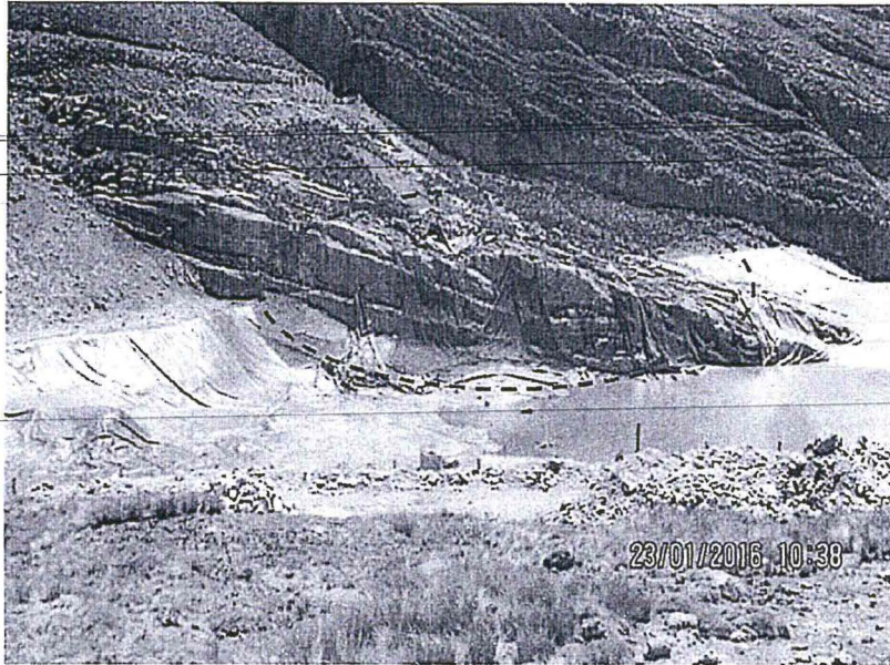
Fotografía N° 064: Hallazgo N° 5: Otra vista donde se observa que parte de la geomembrana de la margen izquierda del espejo de agua se encontraba rasgada y fuera de su lugar, en comparación con el resto de la geomembrana que si se encuentra en su lugar original.
