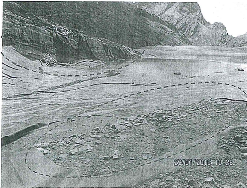
Fotografía N° 063: Hallazgo N° 5: Vista donde se observa que parte de la geomembrana de la margen izquierda del espejo de agua y la del talud de la margen derecha que se encontraban rasgada y fuera de su lugar del depósito de relaves Oasis.
