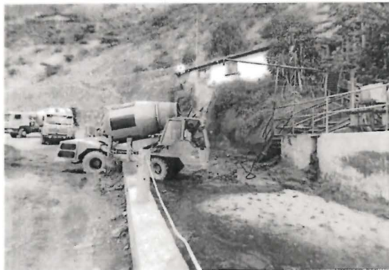
Fotografía N° 275.- En el área donde se realiza el lavado manual de las unidades de la empresa UNICON, los vehículos descargan restos de concreto directamente al suelo, los cuales por gravedad van a una poza de sedimentación, que presenta paredes de concreto.
