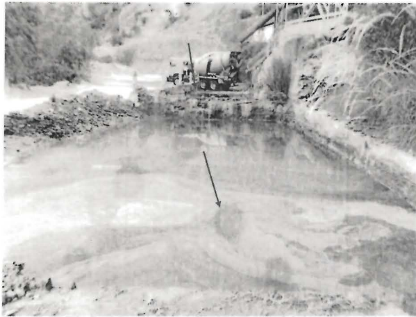
Fotografía N° 278.- En el área donde se realiza el lavado manual de las unidades de la empresa UNICON, los vehículos descargan restos de concreto directamente al suelo, los cuales por gravedad van a dos pozas de sedimentación, una presenta paredes de concreto y la segunda está habilitada sobre el suelo.
