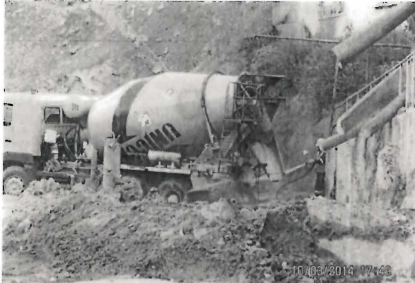
Fotografía N° 277.- En el área donde se realiza el lavado manual de las unidades de la empresa UNICON, los vehículos descargan restos de concreto directamente al suelo.
