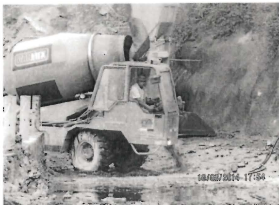
Fotografía N° 276.- En el área donde se realiza el lavado manual de las unidades de la empresa UNICON, los vehículos descargan restos de concreto directamente al suelo.
