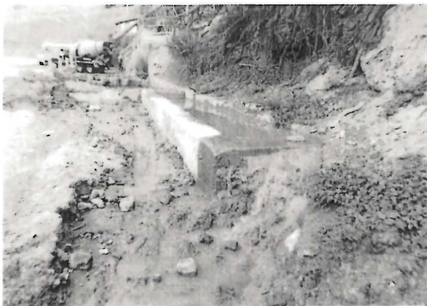
Fotografía N° 279.- Luego de la segunda poza, existe un canal de concreto, verificándose que se encontraba colmatada, razón por la cual se advirtió que el agua salta por rebose hacia la vía de acceso.
