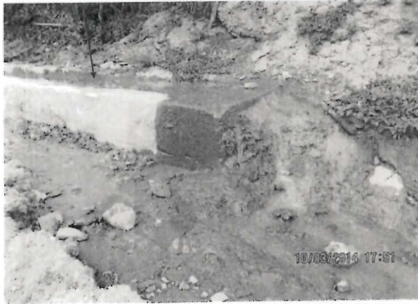
Fotografía N° 280.- Luego de la segunda poza, existe un canal de concreto, verificándose que se encontraba colmatada, razón por la cual se advirtió que el agua salía por rebose hacia la vía de acceso.
