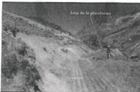
Fotografía N° 030: Plataforma de perforación S/N, el área se encontraba sin perfilar. Asimismo, en dicha área se observó dos (02) sondajes de perforación identificados con códigos SDO 026 y SDO 027-15, los mismos que presentaban una tubería de PVC y bloque de concreto en cada uno.
