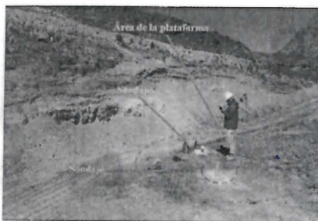
Fotografía N° 031: Plataforma de perforación S/N, el área se encontraba sin perfilar. Asimismo, en dicha área se observó dos (02) sondajes de perforación identificados con códigos SDO 026 y SDO 027-15, los mismos que presentaban una tubería de PVC y bloque de concreto en cada uno.
