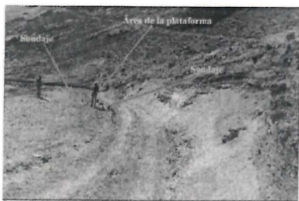
Fotografía N° 032: Plataforma de perforación S/N, el área se encontraba sin perfilar. Asimismo, en dicha área se observó dos (02) sondajes de perforación identificados con códigos SDO 026 y SDO 027-15, los mismos que presentaban una tubería de PVC y bloque de concreto en cada uno.
