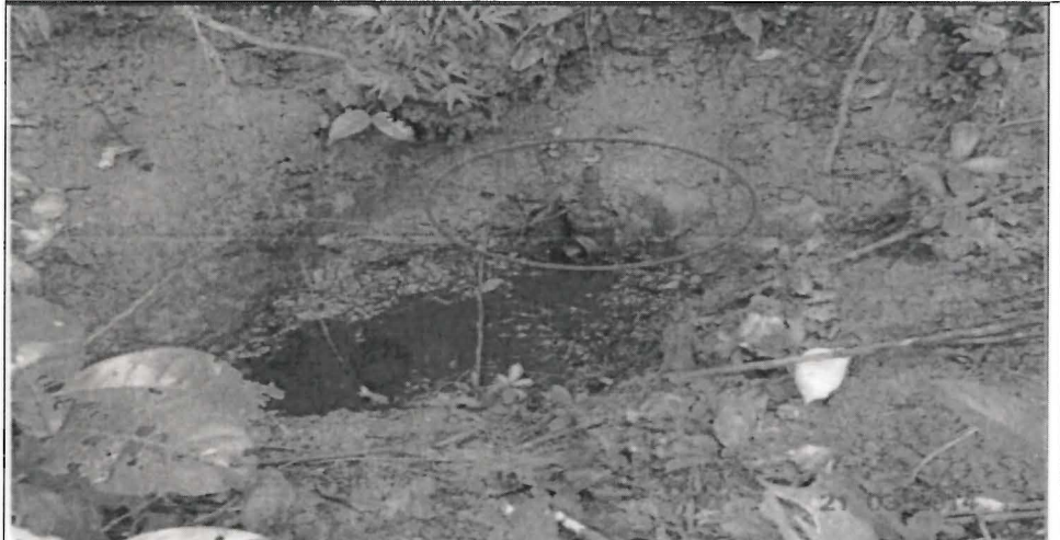
Foto N° 22: Muestra el punto donde drena la cantina del Pozo Inyector MA-32, se observa la válvula de control de 2" a través del cual drena los fluidos de la cantina, se evidencia presencia de hidrocarburo en el punto de vertimiento de los fluidos líquidos. Maple se comprometió a eliminar este punto de drenaje.
