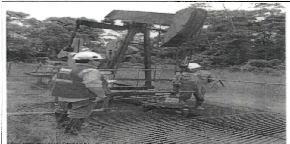
Foto N° 20: Muestra la instalación del Pozo Productor MA-32, conexiones de cabezal y cantina en buen estado.
