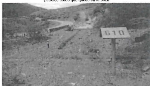
Fotografía N° 15: Vista de actividades de acondicionamiento de poza de contención para actividades de mantenimiento, ubicada en el Km 610 de la Progresiva del ONP (altura km 113 de la carretera Fernando Belaunde Terry, Bagua – Chiclayo). Tubería enterrada, no se observó fuga o derrame de petróleo crudo.
