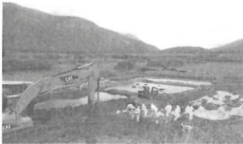
Fotografía N° 6: vista de las tres pozas de recuperación (petróleo crudo y agua)
