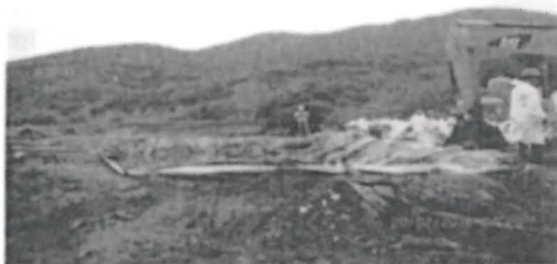
Fotografía N° 10: Vista de una poza de confinamiento, la cual esta impermeabilizada con plástico y se encuentra casi vacía, ya que el producto ha sido bombeado a una cisterna para su posterior traslado.
