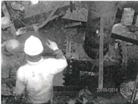
Foto N° 1. Lugar del incidente ocurrido el 26.06.14, puede observarse a los operarios que realizaban ajuste y desajuste de pernos para el drenaje de petróleo crudo de la brida ciega, preparando el bombeo de petróleo crudo hacia un tanque. Ubicado en coordenadas UTM 508629E - 9478457N.
