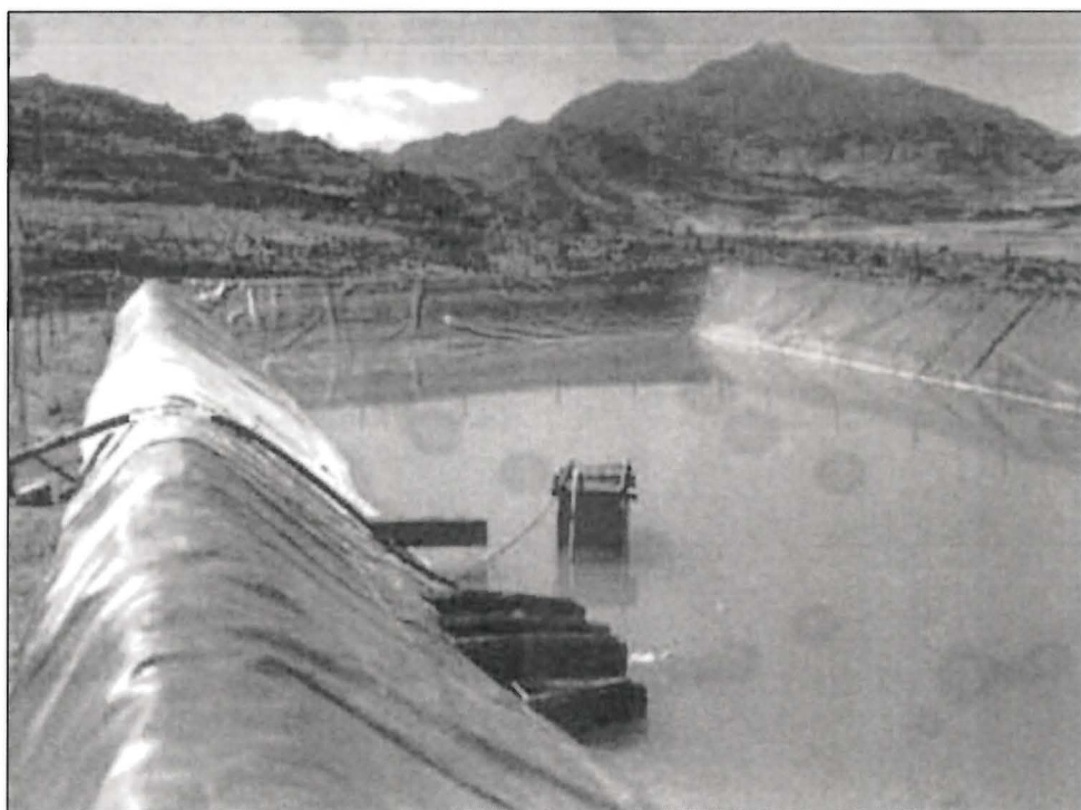
Fotografía N° 1.- Bomba sumergible en una barcaza, en pleno funcionamiento, la tubería de derivación, está dirigida a la poza de sedimentación de la planta de tratamiento de aguas ácidas.
