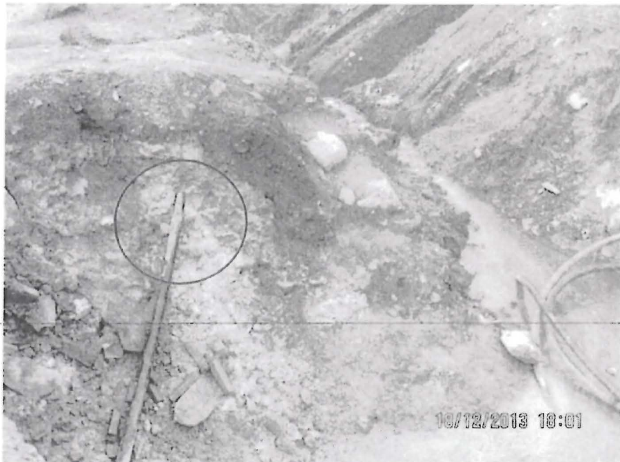
Fotografía N° 54.- Se constató que por la tubería HDPE de 3" de color negro se descarga agua a la quebrada, proveniente del sector 4 Mina Quebrada Honda.
