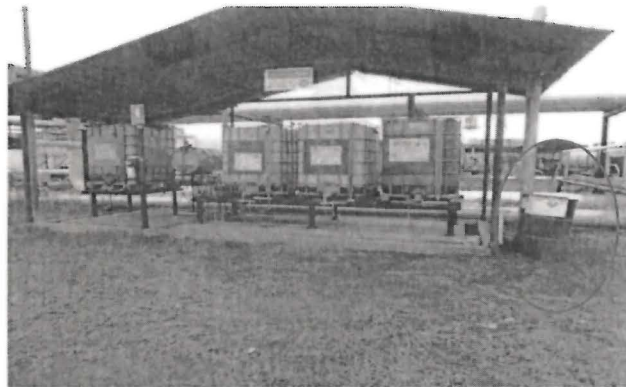
Foto N° 22. En la Gathering Station adyacente a la caseta de los productos químicos, se encuentra dispuesto un cilindro de 55 galones vacío en un área sin sistema de contención de derrames. Coordenadas UTM WGS84 338045E 9689903N
