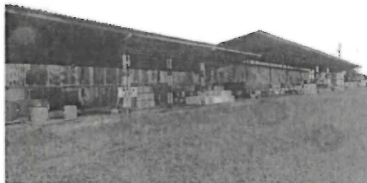
Foto N° 11. Área J-01 se detectó el almacenamiento de productos químicos y lubricantes en un área sin dique de contención de derrames. Coordenadas UTM (WGS84): 338144E 9686602N
