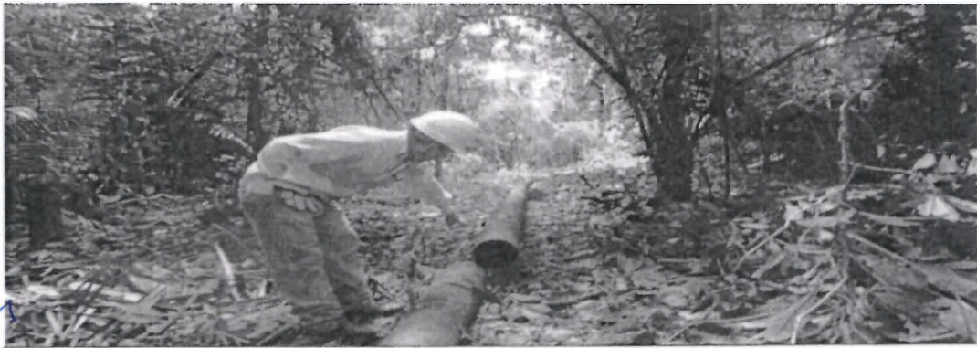
FOTO N° 12: En la vista fotográfica se observa el último corte del oleoducto. Se observa al oleoducto en estado de abandonado, sin el mantenimiento, sin la protección del caso, cuyas superficies se encuentran oxidadas. Se observa en el derecho de vía, árboles y otras vegetaciones crecidos, lo que evidencia que el DdV no ha recibido mantenimiento alguno por mucho tiempo.
