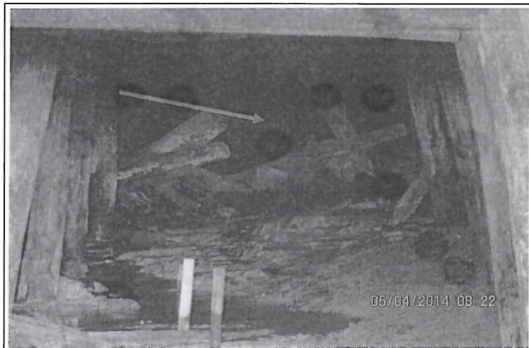
FOTO N° 6: Vista del interior de la bocamina, donde se aprecia un derrumbe que obstruye el paso.
