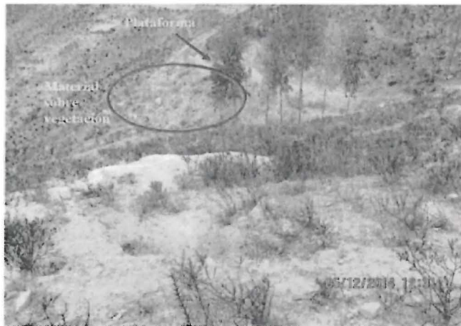
Fotografía N° 39: Hallazgo N° 4 Supervisión 2014. Se observa la parte baja de la plataforma con el sondaje BDC 22, se aprecia que el material de desbroce de la construcción de la plataforma se encuentra sobre la vegetación existente. (Fotografía tomada desde una ladera frontal)
