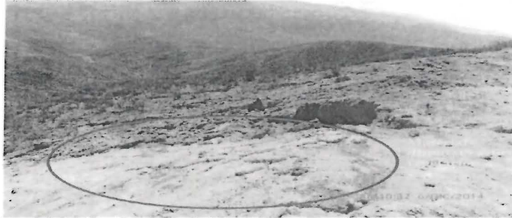
Fotografía N° 16: Plataforma sin bloque de cemento. Ubicada en las coordenadas UTM Datum WGS-84 9 093877N 765222E. En la parte baja de la plataforma se encuentra erosionada y también existe material (suelo y rocas) dispuesto sobre la vegetación.
