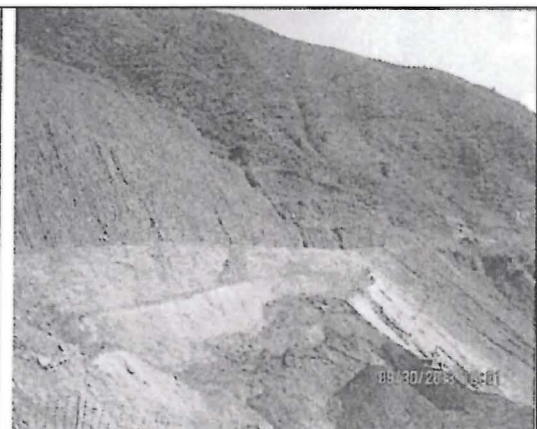
Vista 8. Tramo con inestabilidad y deslizamiento de taludes.
