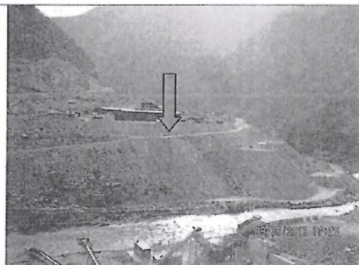
Vista 12. DME-B2 Yanarumi, parte aguas abajo, sin disposición en forma de banquetas, perfilado, sistemas de drenaje y, con pendientes mayores de 1,5:1 (H:V).
