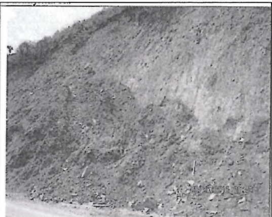
Vista 4. Tramo con Inestabilidad y deslizamiento de taludes de corte. Sin banquetas y/o terrazas ni estructuras de drenaje.
