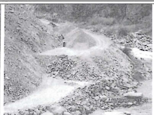
Vista 14. DME-B2 Yanarumi, parte aguas abajo, sin compactar, sin perfilar e invadiendo el cauce del río Mantaro.
