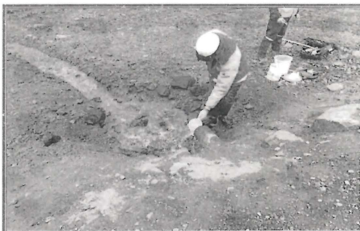
FOTOGRAFÍA N° 134.- Hallazgo N° 12: Descarga al ambiente de la poza final del sistema de tratamiento.
