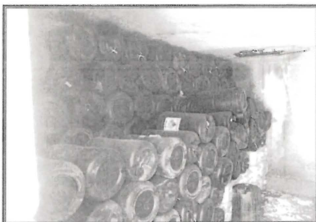
FOTOGRAFÍA N° 94.- Hallazgo N° 6: Envases peligrosos almacenados. Se observa la rotura en el techo y las manchas de escurrimiento de agua en la pared, además se observa pintura desprendida por acción del agua.
