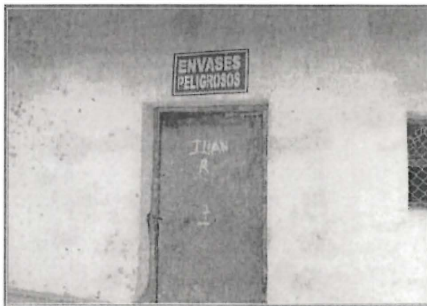
FOTOGRAFÍA N° 93.- Hallazgo N° 6: Almacén de envases peligrosos.
