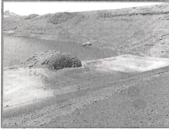
FOTOGRAFÍA N° 85.- Hallazgo N° 3.- Pozas en construcción del sistema de tratamiento pasivo de agua de proveniente de los relaves (wetland). Este sistema no se encuentra contemplado en los instrumentos de gestión ambiental.
