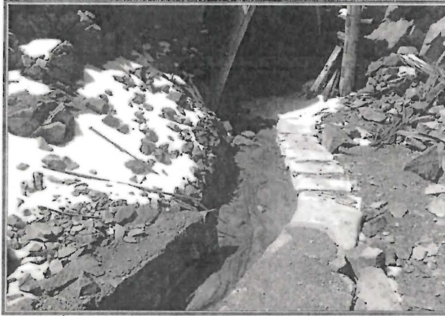
FOTOGRAFÍA N° 125.- Hallazgo N° 12: Agua de mina de la bocamina Benevento. Están canalizadas y dirigida al sistema de tratamiento respectivo.
