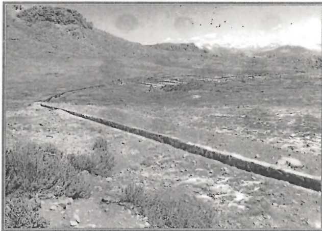
FOTOGRAFÍA N° 128.- Hallazgo N° 12: Canal de derivación de las aguas de mina después del tratamiento con cal y floculantes.
