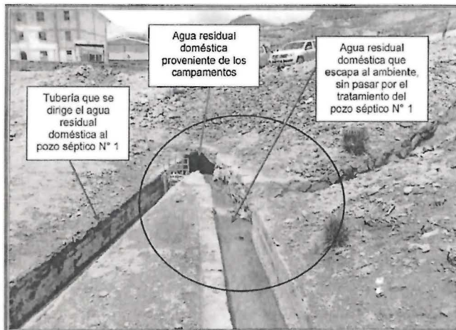
FOTOGRAFIA N° 103.- Hallazgo N° 8: canales de derivación de aguas residuales domésticas. Se observa que parte del agua residual doméstica se dirige a un canal de derivación y otra parte al pozo séptico.
