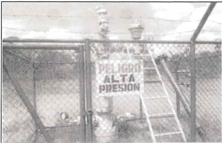
Fotografía N° 10: Pozo 9X del campo 31 C.
