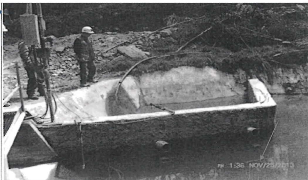
Fotografía N° 97: En la poza contigua al punto SW-26 (1) en la quebrada Pacchac, con coordenadas UTM N: 8953254 y E: 217398, se verificó evidencia de rebose del agua ácida captada del punto ARD-17. Asimismo, se observó que el administrado no cuenta con un sistema o mecanismo (por ejemplo, bomba en stand by) que evite estos casos de contingencia
