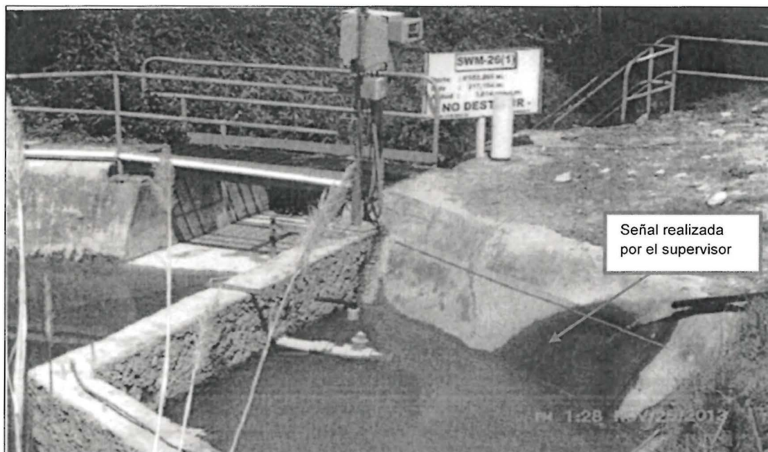
Fotografía N° 98: Vista de la señal de nivel de agua en la poza (línea roja) evidenciando que existió rebose del agua ácida en la quebrada Pacchac.
