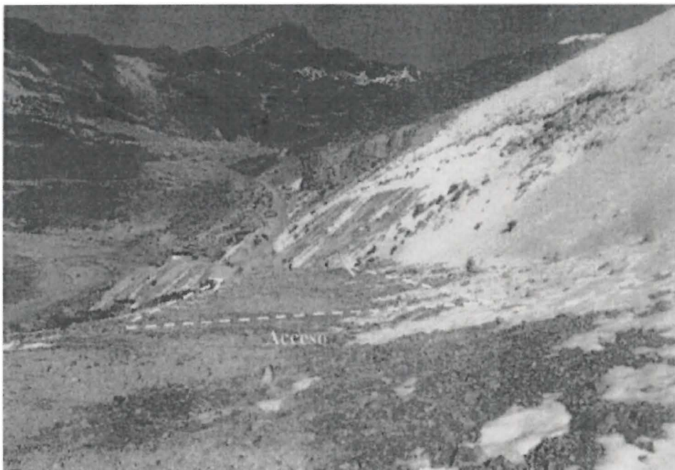
Fotografía N° 008: Acceso a la Plataforma de perforación P-12, no se encontraba perfilado ni revegetado. Asimismo, se observó que dicho acceso presentaba rocas sueltas.
