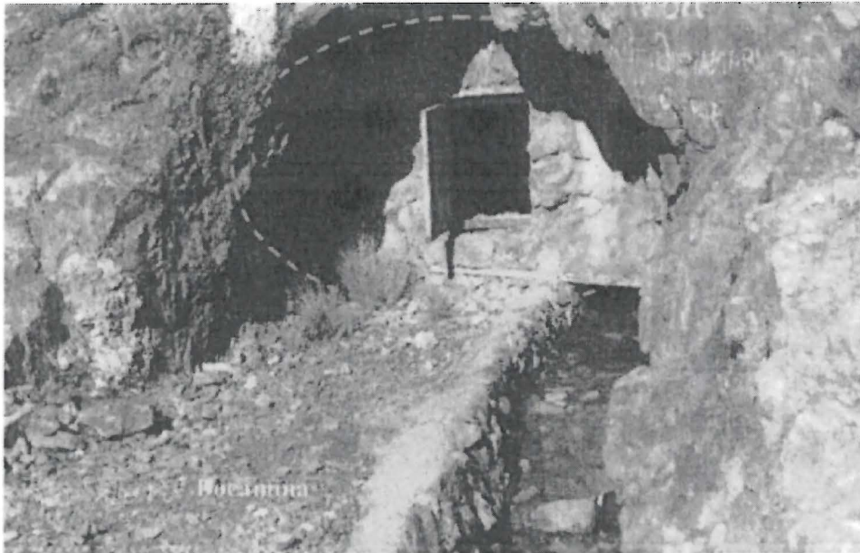
Fotografía N° 016: Bocamina - Plat Que 56, presentaba una pared de piedra y concreto. Asimismo, contaba con una tapa metálica abierta en el medio de dicha pared. Por otro lado se verificó un canal de drenaje construido de piedras, desde donde discurría agua desde el interior de la bocamina, infiltrándose por la superficie del terreno al final de dicha cuneta.
