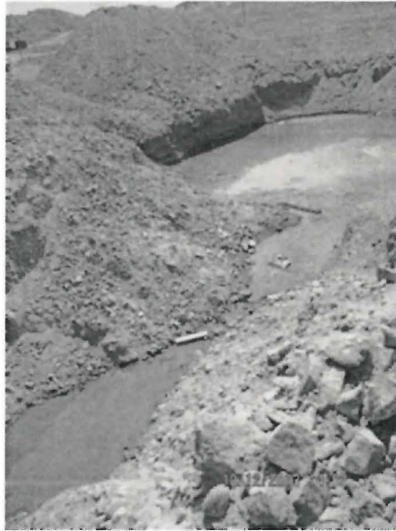
Fotografía N°229. Recomendación N° 5 de la supervisión regular 2011. Zanja de infiltración de efluente doméstico abierta del Pozo séptico N° 1, el titular minero ha incumplido con ejecutar la recomendación dejada.
