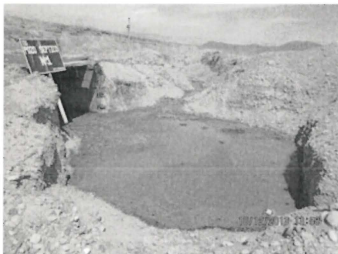
Fotografía N°226. Recomendación N° 5 de la supervisión regular 2011. Pozo séptico N° 1 con evacuación de efluente doméstico, el titular minero ha incumplido con ejecutar la recomendación dejada.
