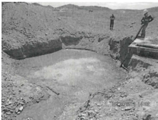
Fotografía N°228. Recomendación N° 5 de la supervisión regular 2011. Pozo séptico N° 1 con evacuación de efluente doméstico, el titular minero ha incumplido con ejecutar la recomendación dejada.
