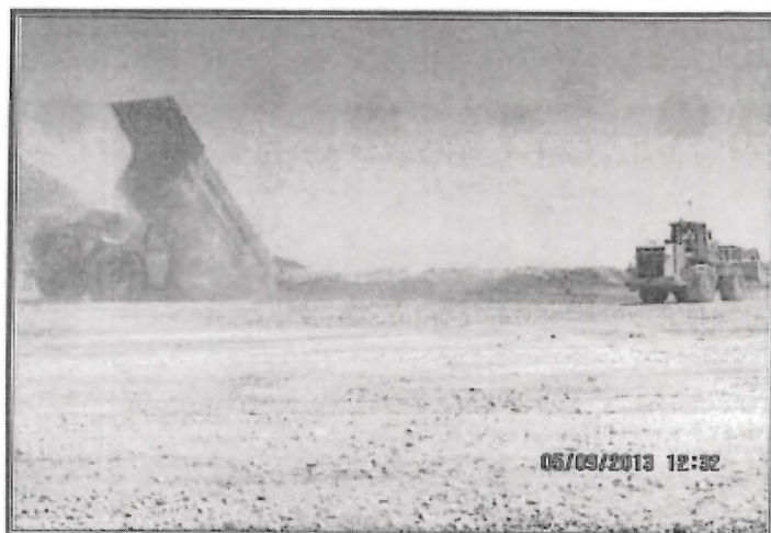
Fotografía N° 35: Hallazgo N° 3. Disposición de desmorte en el Depósito de Desmorte Torata Oeste. Se constató que en la disposición de desmorte en el Depósito de Desmorte Torata Oeste, no se riega las vías y plataforma de descarga del desmorte, lo cual genera la emisión de material particulado.
