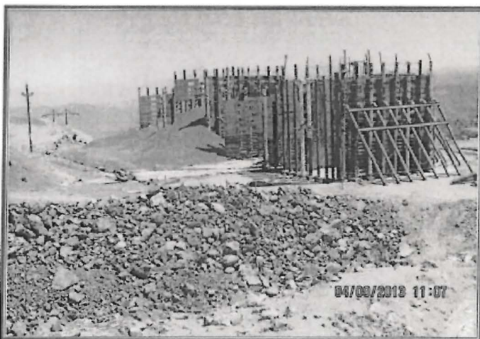
Fotografía N° 116: Hallazgo N° 6 Infraestructura de prueba piloto de mineral oxidado. Dentro de las instalaciones de la Concesión de Beneficio de Lixiviación Cuajone, se constató la existencia de una infraestructura de prueba piloto de mineral oxidado para proyectos de lixiviación. En las inmediaciones existen restos de mineral.
