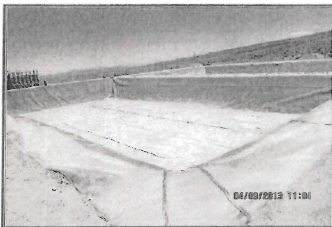
Fotografía N° 114: Hallazgo N° 6 Infraestructura de prueba piloto de mineral oxidado. Dentro de las instalaciones de la Concesión de Beneficio de Lixiviación Cuajone, se constató la existencia de dos pozas impermeabilizadas correspondientes a una infraestructura de prueba piloto de mineral oxidado para proyectos de lixiviación.
