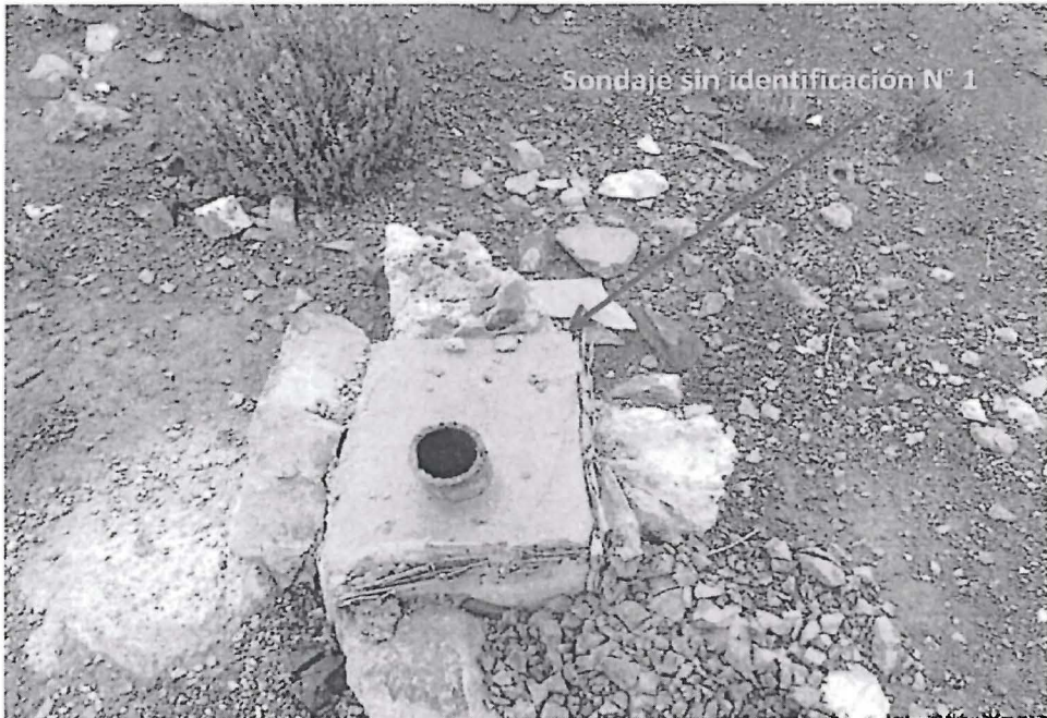
Fotografía N° 032: Dado de concreto indicador de un sondaje en la plataforma de perforación HUA 10-004. Nótese la ausencia de identificación del sondaje.
