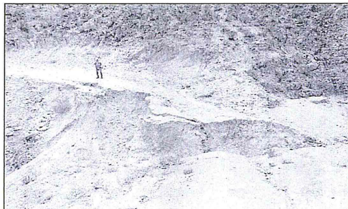
Fotografía N° 51.- Acceso a la plataforma de perforación con código de sondaje BDC-08 y BCD-08A, en el cual se observó presencia de cárcavas. Falta perfilar y revegetar.
