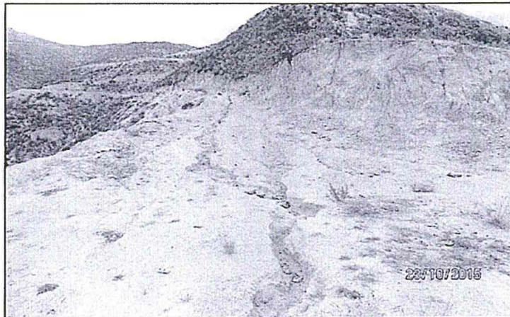
Fotografía N° 49.- Acceso a la plataforma de perforación con código de sondaje BDC-08 y BCD-08A, en el cual se observó presencia de cárcavas. Falta perfilar y revegetar.
