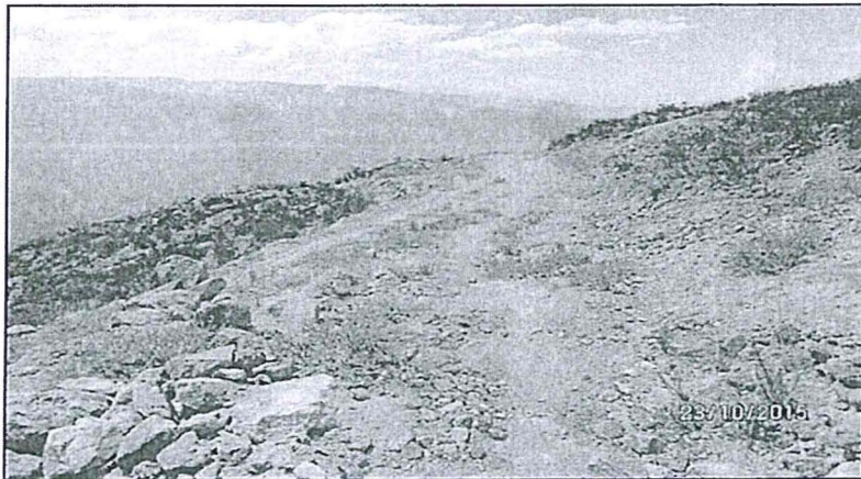
Fotografía N°41.- Acceso a la plataforma de perforación con código de sondaje BDC-11, en el cual se observó rocas sueltas. Falta perfilar y revegetar.
