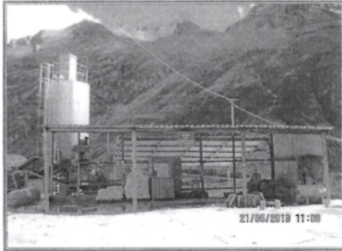
FOTOGRAFIA N° 464. - A la altura del Nivel 4320 de la zona Riqueza (bocamina operativa) se constató la existencia de la Planta de Shotcrete. Esta infraestructura no está contemplada en el EIA, coordenadas UTM datum WGS84: 8 901 843 N, 275 071 E y 4 325 msnm. Hallazgo N° 21 - 2013.
