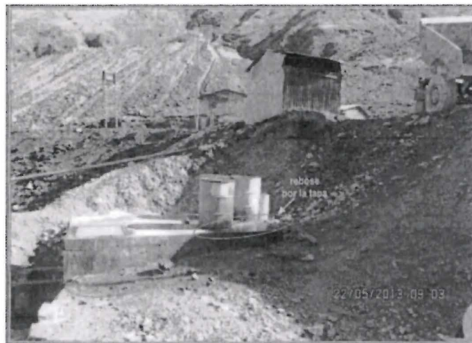
FOTOGRAFIA N° 478.- El taller de mantenimiento trackless cuenta con una trampa de grasa donde se observó rebose por la tapa de registro. Nótese los indicios de haberse producido derrame por las manchas y el color del suelo. Las coordenadas UTM datum WGS 84 de la trampa de grasa son: 8 901 889N 274 797E. Hallazgo N° 48-2013.
