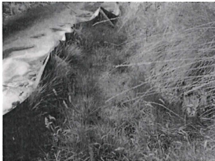
Fotografía N° 51: Relaves sobre suelo natural en la margen izquierda del canal de geomembrana.
