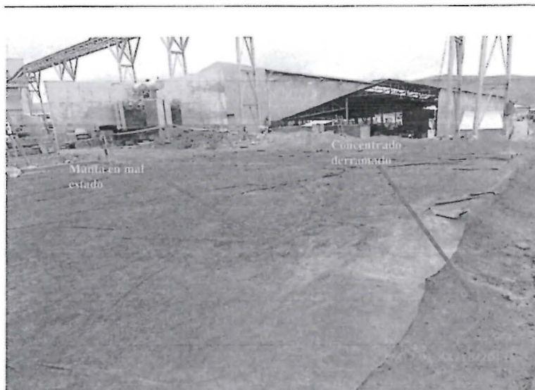
FOTO N° 83: Hallazgo N° 9, Supervisión 2013: Otra vista de la manta en mal estado donde se aprecia partículas de mineral a la intemperie y derrame de concentrados en suelos aledaños.
