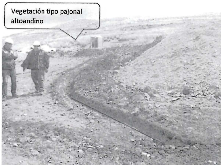
Fotografía N° 43.- HALLAZGO 01: Otra vista de la parte inferior de la plataforma contigua a la Plataforma donde se ubican los sondajes TF1-002 y TF1-003 (coordenadas UTM WGS 84 N-8 345 381, E-257 023). El canal de coronación para escorrentías en esta zona (flecha roja) no cuenta con poza de sedimentación al final.
