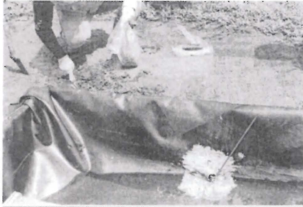
Fotografía N° 3: Locación San Martín 3 Drenaje de aguas pluviales abierta de la zona estancia del tanque de Diesel.
