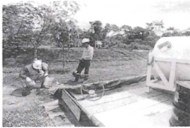
Fotografía N° 2: Locación San Martín 3 Drenaje de aguas pluviales abierta de la zona estanca del tanque de Diesel.
