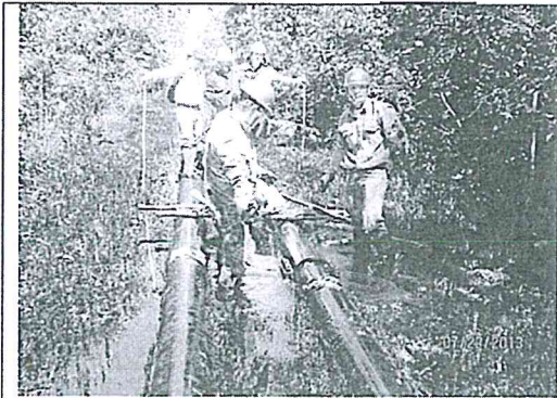
Foto N° 1: Muestra GRAPA instalada en el DUCTO con la finalidad de cubrir la fisura para controlar el derrame. Considera que la instalación de la GRAPA es temporal.
