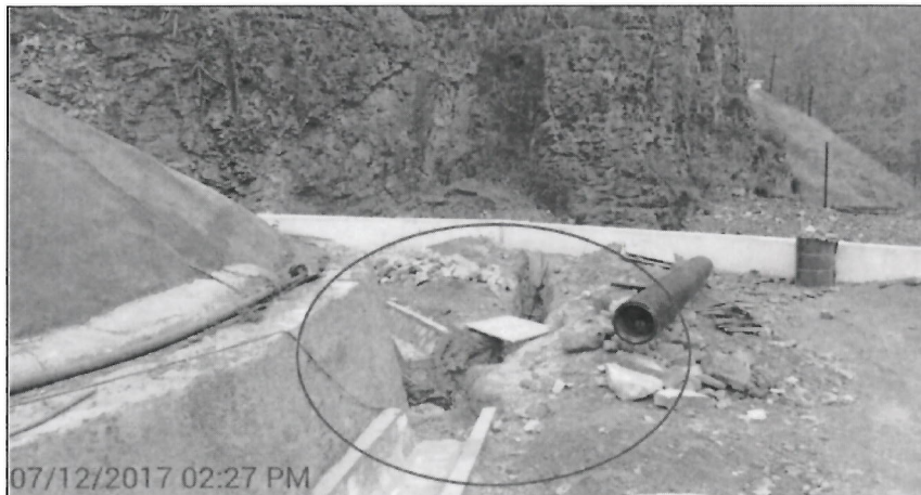
Fotografía N° 1. Zona de ubicación al pie del Depósito de Relaves Triana, en donde se evidencia la inexistencia de la poza de colección que sirve de mecanismo de contingencia ante a posible infiltración del agua de escorrentía en los relaves del Depósito de Relaves Triana. Acción de supervisión del 7 al 8 de diciembre de 2017.
