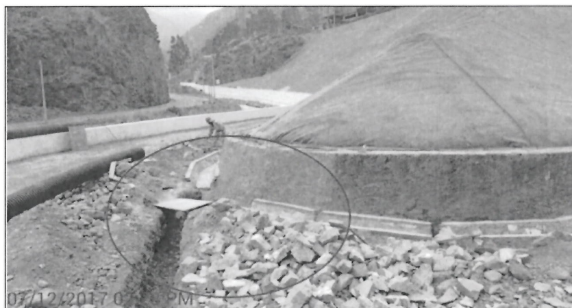
Fotografía N° 2. Otra vista de la zona de ubicación al pie del Depósito de Relaves Triana, en donde se evidencia la inexistencia de la poza de colección que sirve de mecanismo de contingencia ante a posible infiltración del agua de escorrentía en los relaves del Depósito de Relaves Triana. Acción de supervisión del 7 al 8 de diciembre de 2017.
