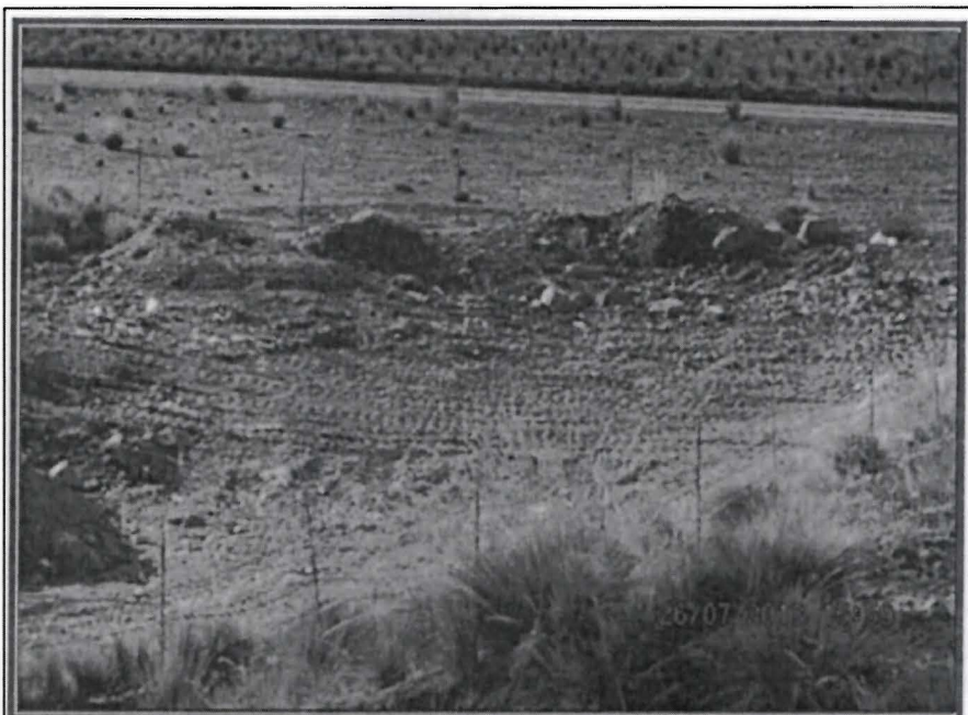
FOTOGRAFIA N° 103.- Vista de planta de una parte del relleno industrial. Se aprecia que los materiales dispuestos sólo son coberturados o tapados con tierra.
