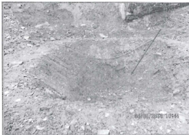
Fotografía N° 99: Vista de la tercera poza de sedimentación de lodos de perforación que se encuentra sin revestimiento de geomembrana a una distancia de cinco (05) metros de las otras dos (02) pozas de sedimentación.
