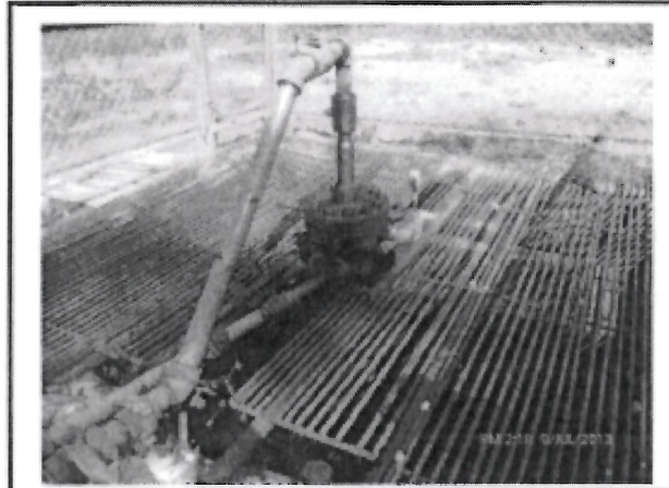
Foto N° 13: Muestra al Pozo productor PA-37, convertido a Pozo Inyector en Enero de 2013. Durante la supervisión no se pudo verificar el rate de inyección, porque el medidor de flujo estaba inoperativo
